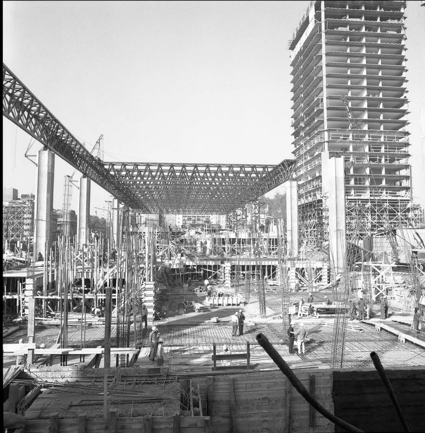
Construcción Edificio Unctad III-Gabriela Mistral-CAP-Maestranza Cerrillos en 1971 [Fotografía], colección Jack Ceitelis Fotógrafo, 1971, Archivo Enterreno ( https://www.enterreno.com/moments/construccion-edificio-unctad-iii-gabriela-mistral-cap-maestranza-cerrillos-en-1971-0ea307cb-395f-41b5-bd58-55b77181c3fc ). Reconocimiento - No Comercial (by-nc)
